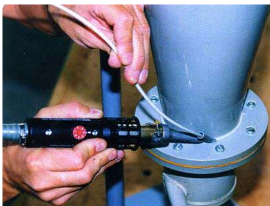
Рис.2.13. Сварка конструкции из пропилена аппаратом ЛАБОР S с насадкой быстрой сварки фирмы Ляйстер
